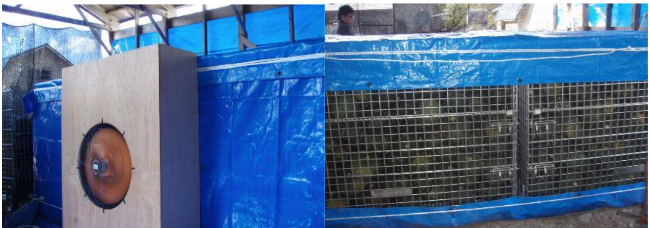
ファン（左）でコンテナ内の空気を吸引することで通気口（右）から効率的に空気を取り入れ通風させる
