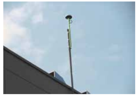
RTK基地局（当JA広域営農センター）
